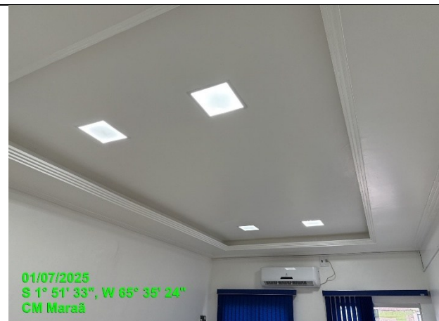
Foto 4 – Forro com luminárias
