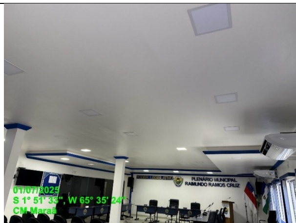
Foto 3 – Forro com luminárias
