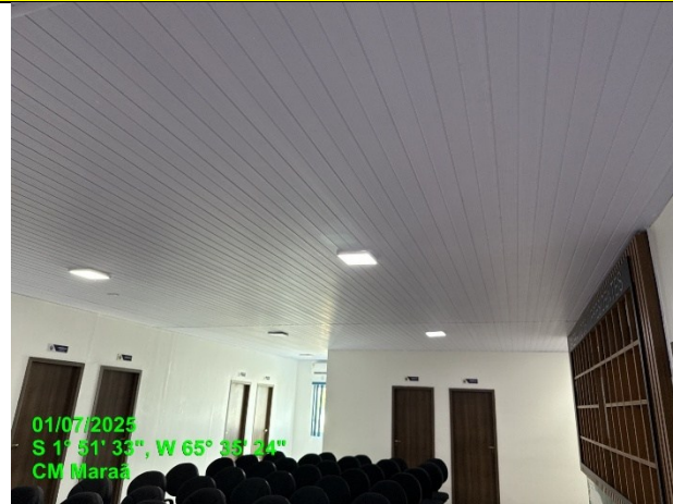
Foto 5 – Forro com luminárias
