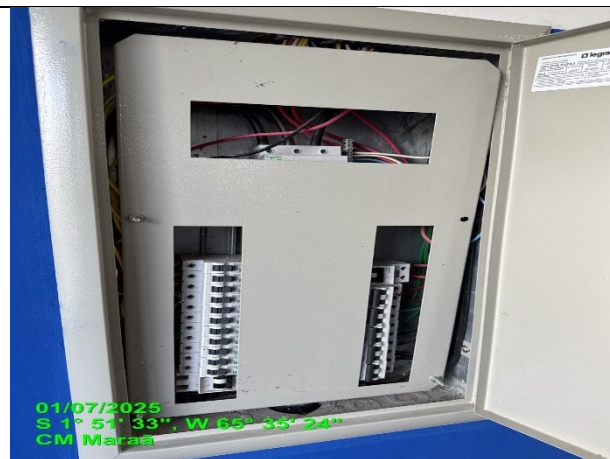
Foto 9 – Quadro de distribuição de energia
